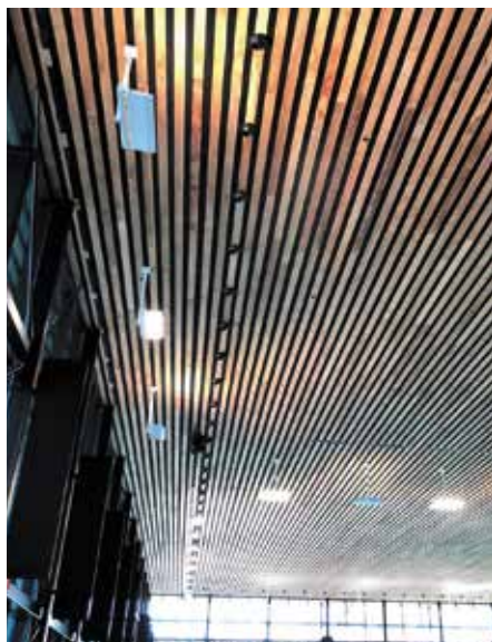
Le réseau de conduits de distribution est intégré au plafond en bois de cèdre.
